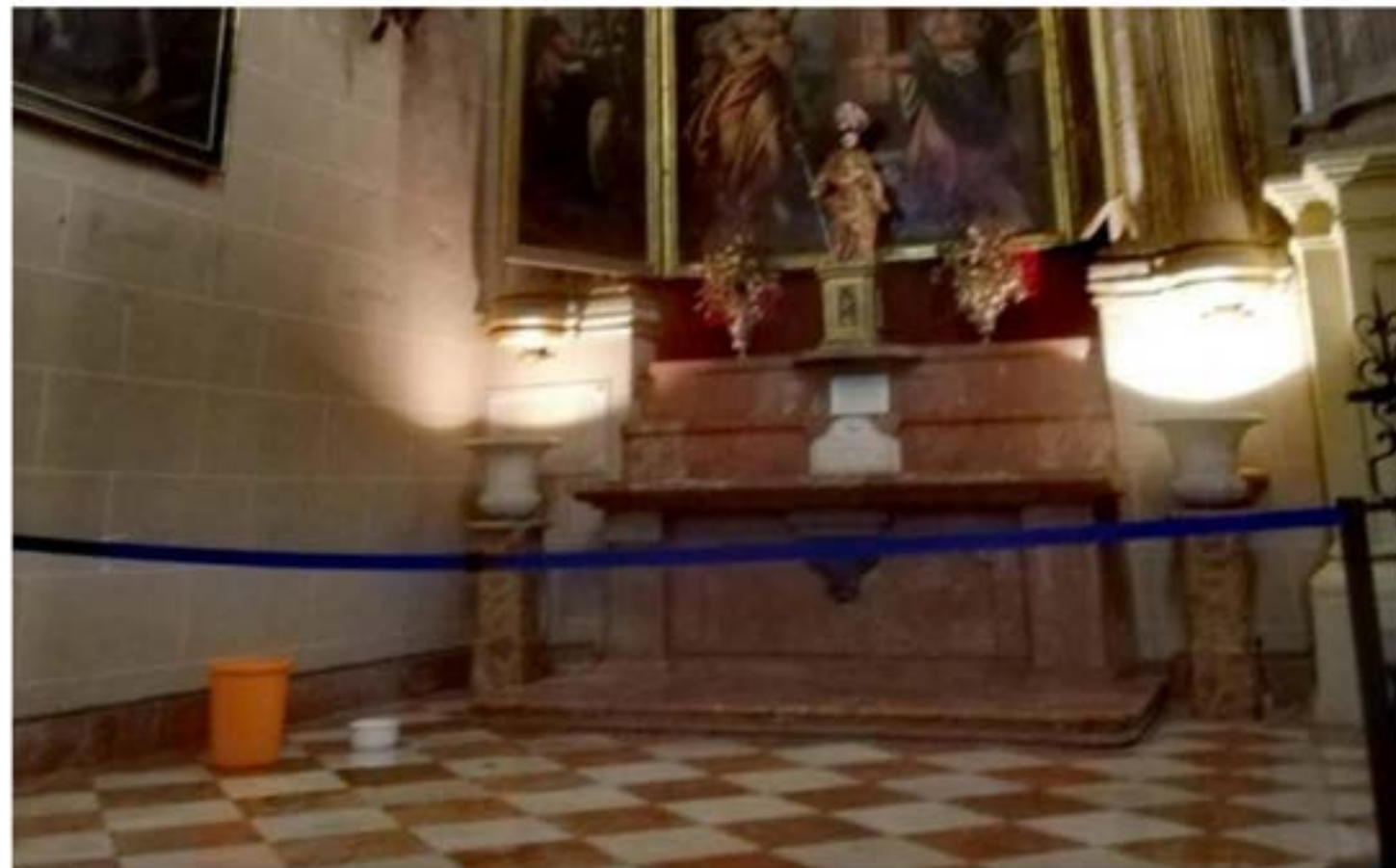
Recipientes colocados en la capilla de San José para recoger las goteras. SUR
