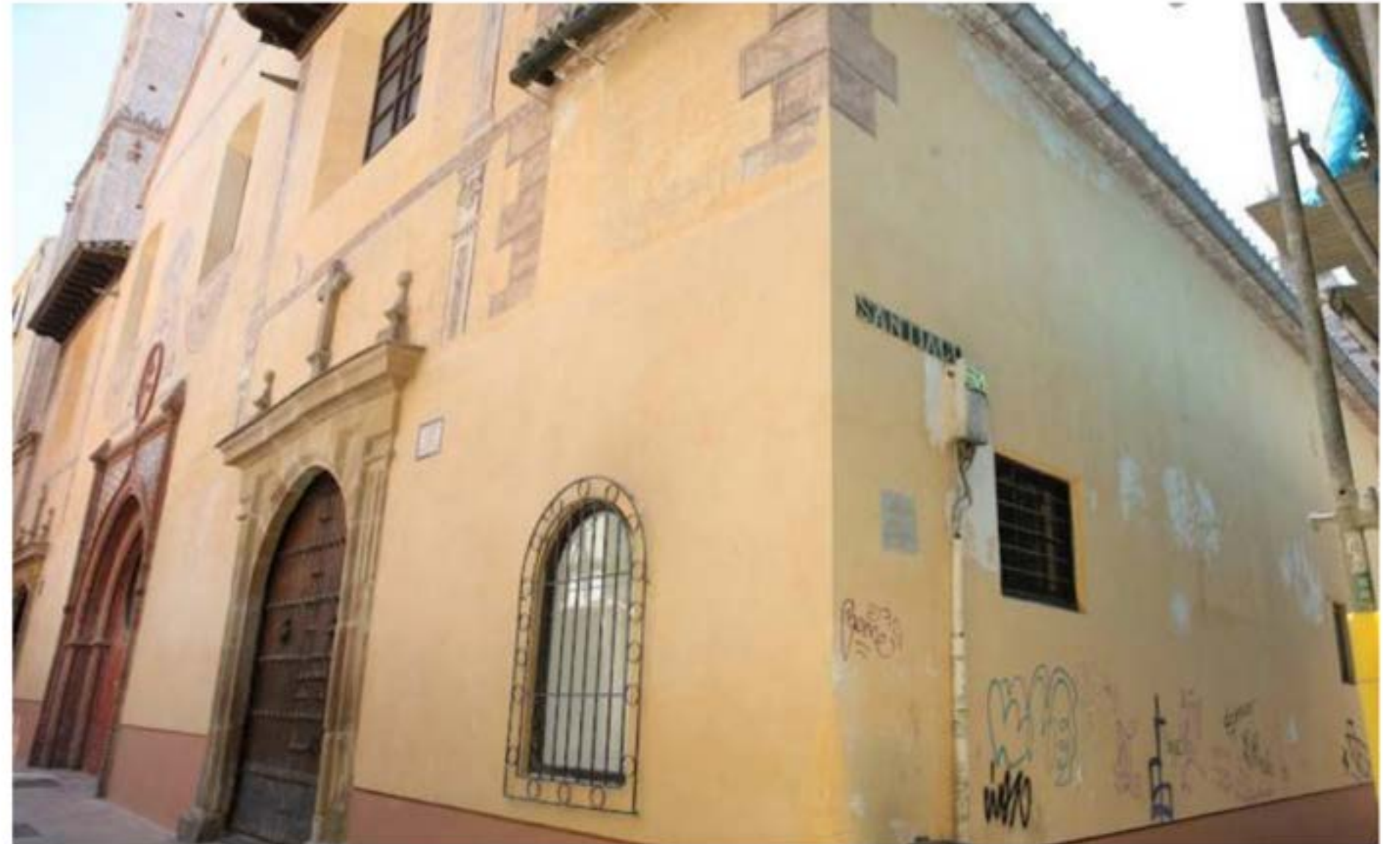
La parroquia de Santiago luce su fachada principal recién restaurada mientras el muro lateral aparece con pintadas, parcheados y cables. Salvador Salas
